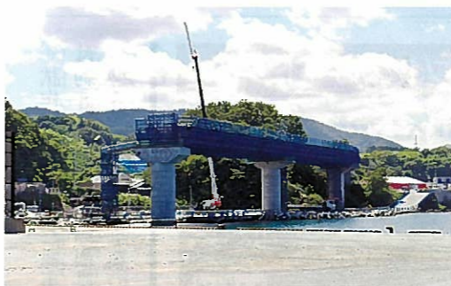
平成29年度の供用開始を目指して工事が進む福井埠頭への取り付け道路
